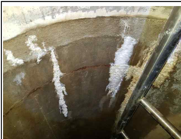
내용 맨홀 수직부 내부 벽체 백태
